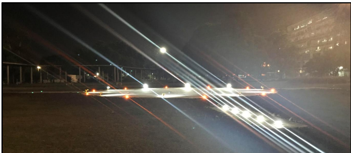
Helipuerto de uso sanitario Hospital Posadas equipado con balizas LS AMG.
